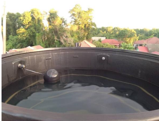
Rajah 4.21 Pelampung tangki tidak berfungsi dan mengakibatkan kebocoran tangki
