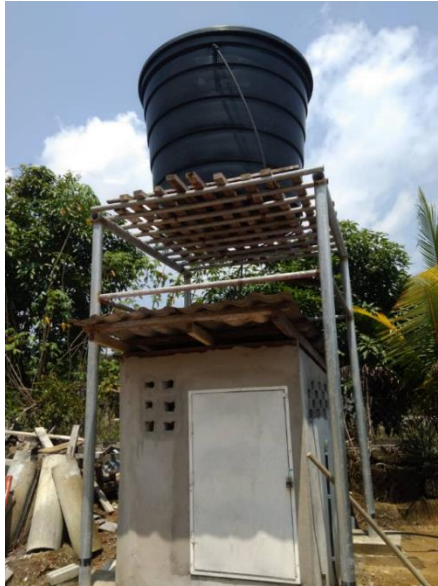
Rajah 4.29 Tangki jenis diletakkan diluar rumah
