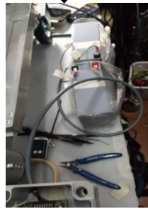
2 bateri 12v disambungkan kepada yang motor
