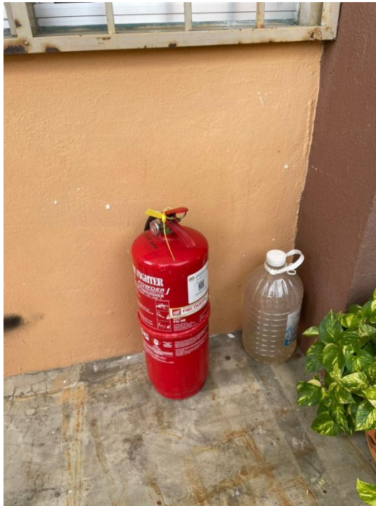
Fire extinguisher yang diletakkan di lantai
