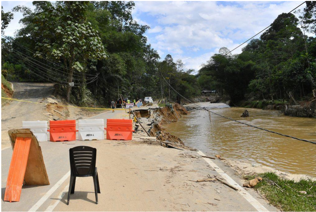
Rajah 9. Jalan Utama Sungai Lui mengalami kerosakan dan bahu jalan telah runtuh selepas berlakunya fenomena kepala air.
