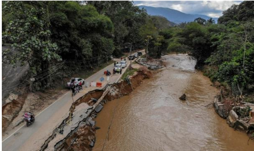
Rajah 4.3.8 Jalan Sungai Lui runtuh disebabkan hakisan.
