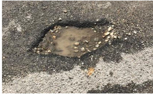
Rajah 1.2 : Jalan berlubang di tempat letak kenderaan pelajar
