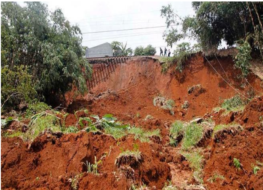
Rajah 2.3.1: Longsor Tanah Punca Kegagalan Cerun
